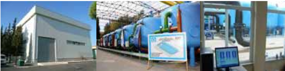
Halkapınar kuyuları arsenik arıtma tesisi
