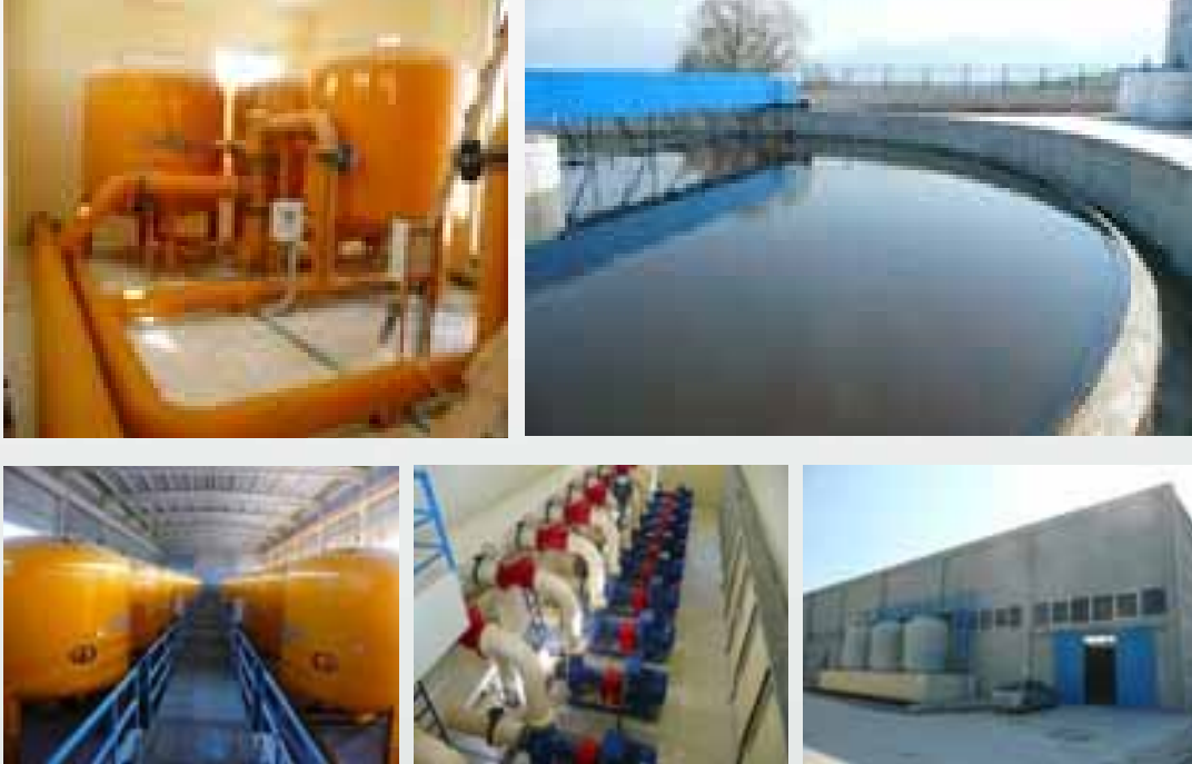
Göksu ve Sarıkız kuyuları arsenik arıtma tesisi
