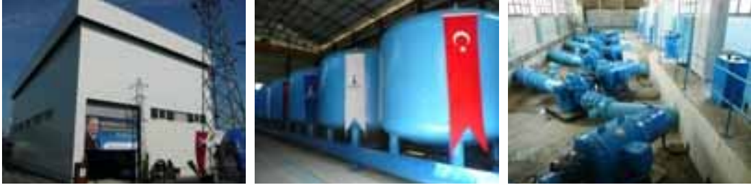
Menemen kuyuları arsenik arıtma tesisi
