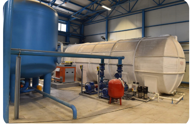
Karaçam İçme Suyu Arıtma Tesisi
