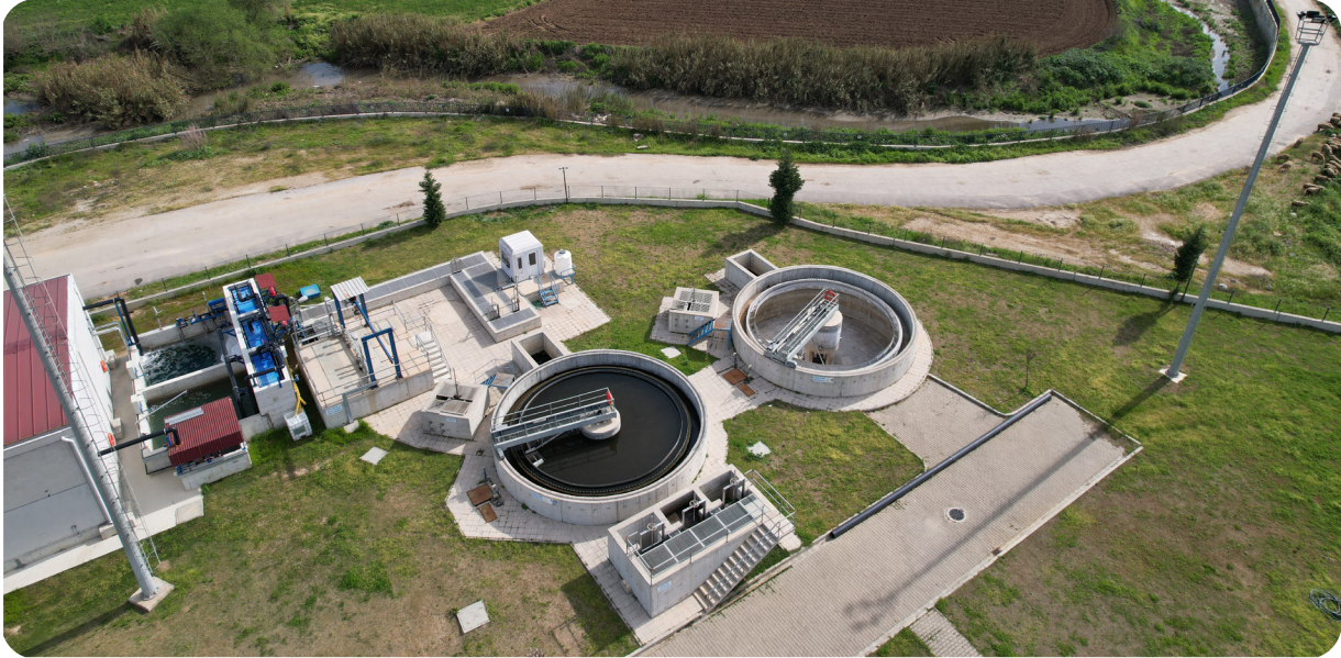
Bayındır Atık Su Arıtma Tesisi Çıkış Suyu Geri Kazanım Tesisi
