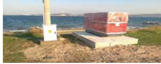
Fo a İl esi Yeni Fo a Atıksu Terfi Merkezleri Elektrik Temini
