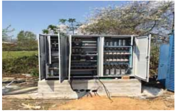
İzmir Bayındır İlçesi İçme suyu Terfi Merkezi Elektrik Temini ve Çevre Aydınlatması
