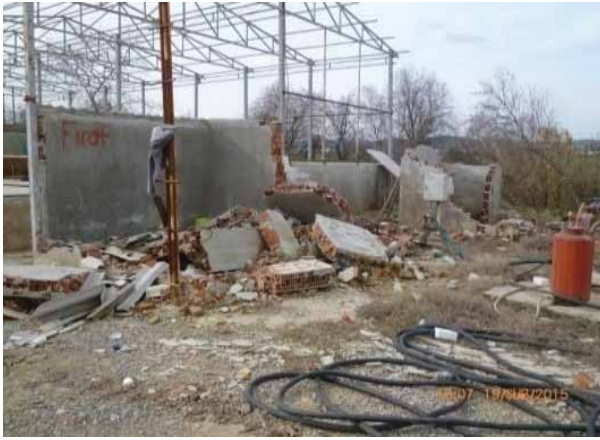
Yıkım Sonrası Kaçak Yapı
