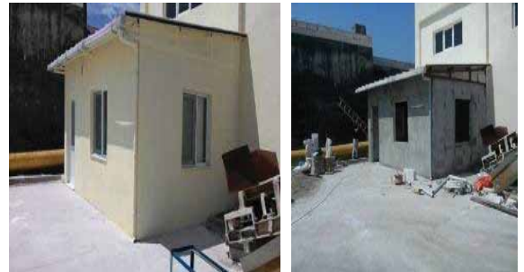
Çullu Arsenik İçme Suyu Arıtma Tesisi Personel Odası
