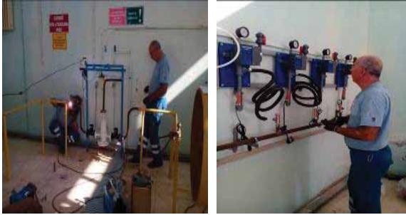
Ürkmez İçme Suyu Arıtma Tesisi Klor Ünitesi
