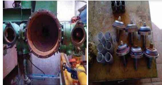
Tahtalı Barajı İçme Suyu Arıtma Tesisinde Çamur Susuzlaştırma Ünitesindeki Yüksek Basıncılı Çamur Pompası
