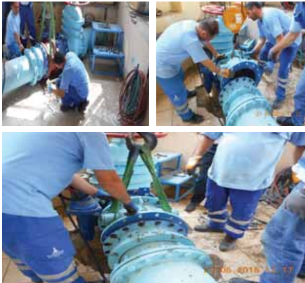
Sarıköz Kuyular bölgesi izolatör ve Camper Değişimi
