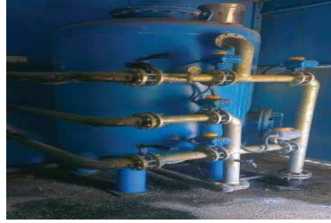
İçme Suyu Paket Arıtma Tesisinden Bir Görünüm
