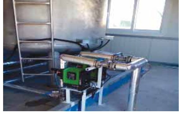
Çeşme İçme Suyu Arıtma Tesisinde Kimyasal Malzeme Tankı ve Dozlama Sistemi
