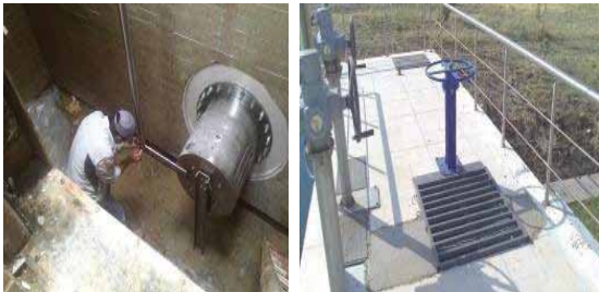
Sarıköz İçme Suyu Arıtma Tesisi'ne Debi Ayarlayıcı Vanası
