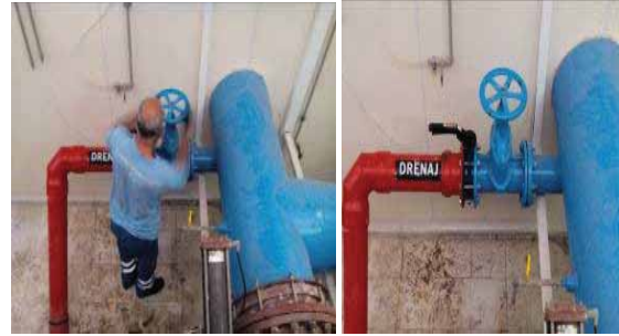
Tahtalı Barajı İçme Suyu Arıtma Tesisinde Filtreler Ünitesindeki Tahliye Vanaları
