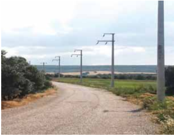
İzmir Menderes İlçesi Bulgurca Mahallesi İçme suyu Kuyusuna Elektrik Temini
