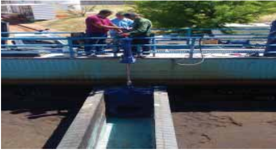
Çeşme İçme Suyu Arıtma Tesisinde Filtre Ünitesi
