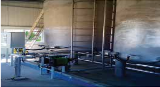
Çeşme İçme Suyu Arıtma Tesisinde Kimyasal Malzeme Tankı
