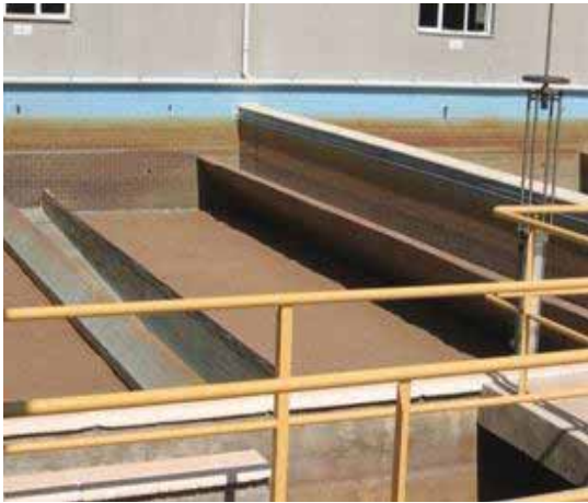
Tahtalı Brj.İçmesuyu Arıtma Tesisi Filtre Ünitesi
