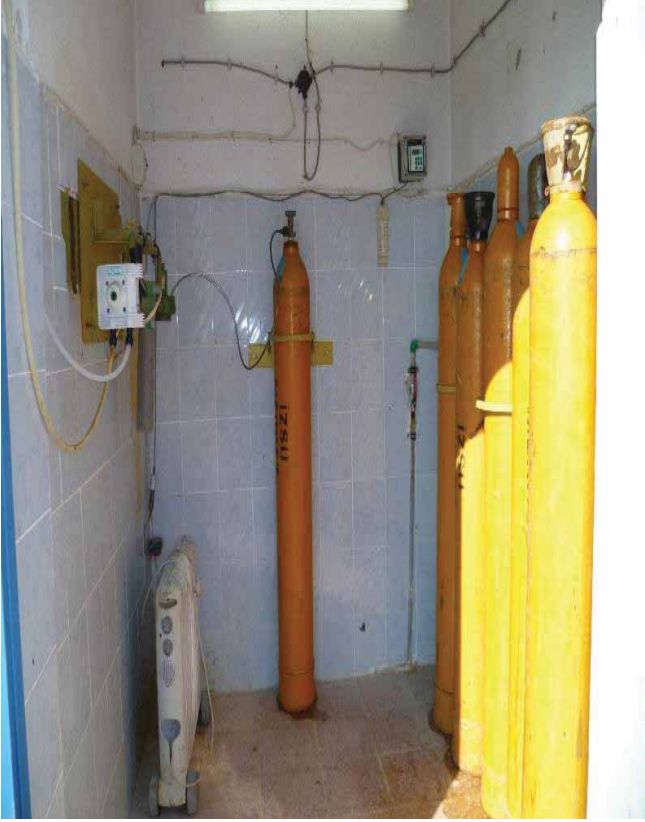
GÜMÜLDÜR TERFİ GAZ KLORLAMA ÜNİTESİ
