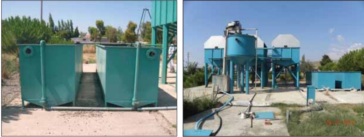
Hacıömerli Atıksu Arıtma Tesisi
