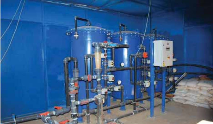
İçme Suyu Paket Tipi Arıtma Tesislerimizden Birinin Kabin ve İç Tesisat Kısmı
