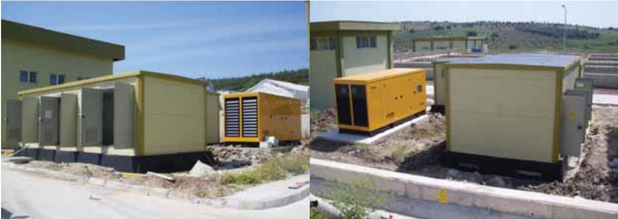
İzmir İli Kemalpaşa Atıksu Arıtma Tesisi Elektrik Temini İşi
