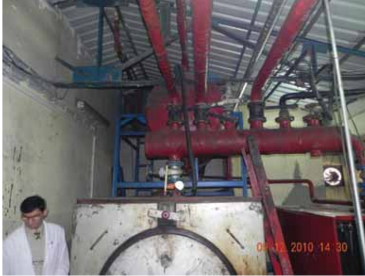
Halkapınar Sular İşletmesi Kazan Dairesi Risk Değerlendirme
