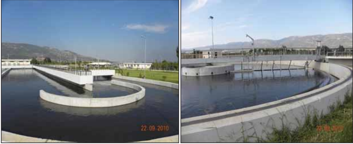
Kemalpaşa Atıksu Arıtma Tesisi
