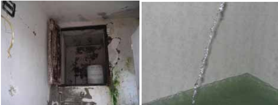
Ürkmez Payamlı Köy Deposu İçi Eski-Yeni Hali
