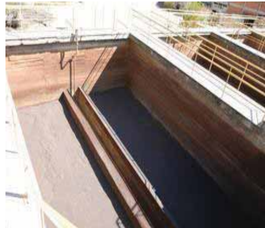
Balçova Brj.İçmesuyu Arıtma Tesisi Filtre Ünitesi
