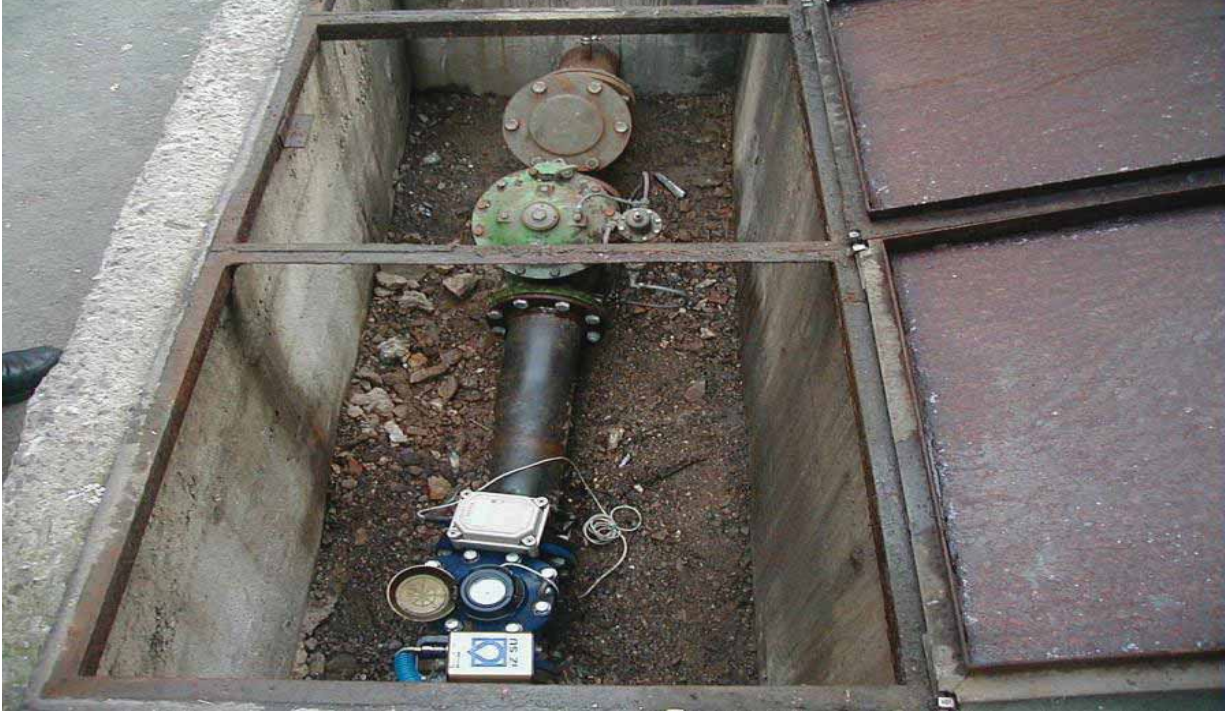
Su Kaçak ve Kontrol Müdürlüğümüzün Kullandığı İzole Bölge Sayaç Rogarı
