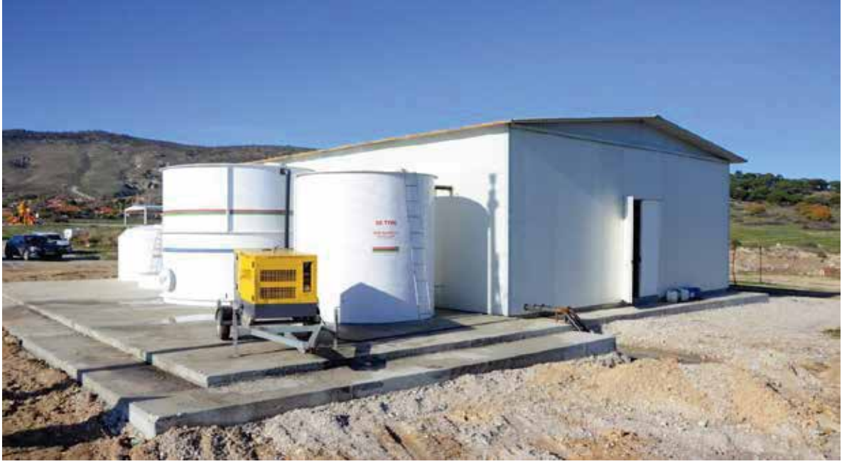
Paket İçme Suyu Arıtma Tesislerinden Görünüm
