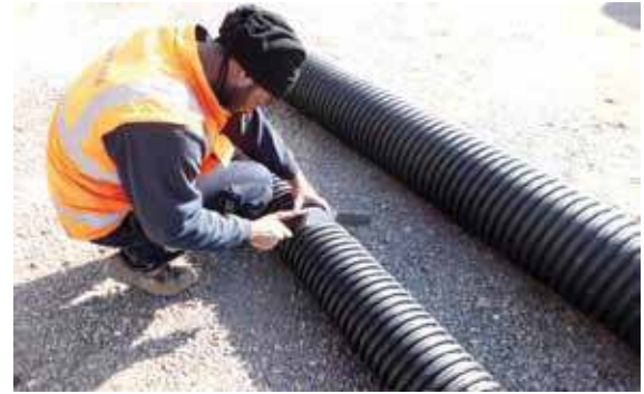
Koruge Borularından Numune Alınması
