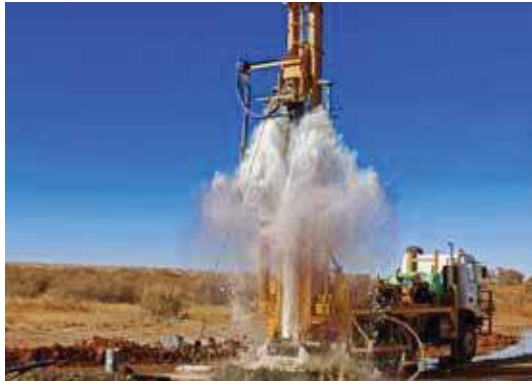
Kiraz İlçesi Kaleköy Mahallesi (Kr.KI-4) Su Sondaj Kuyusu
