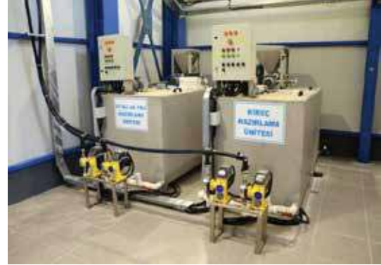
Karaburun Mordoğan Göleti İçme Suyu Arıtma Tesisi
