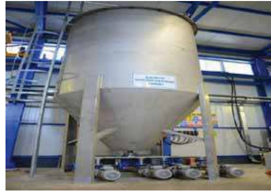
Karaburun Mordoğan Göleti İçme Suyu Arıtma Tesisi
