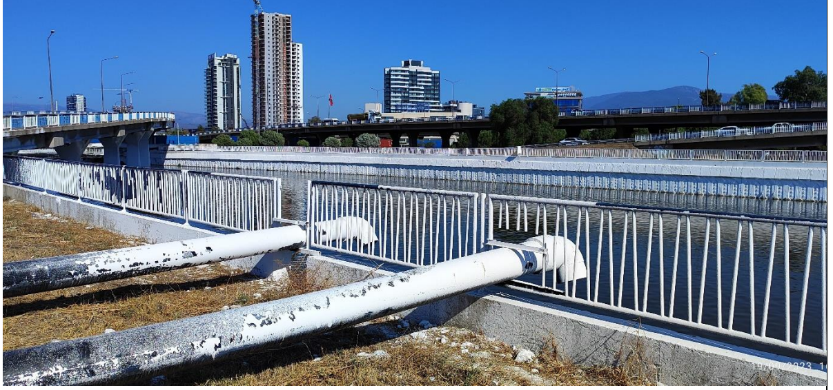
Şekil 3- Mevcut TM1 Terfi Merkezinin Meles Çayı'na Deşarj Noktası
